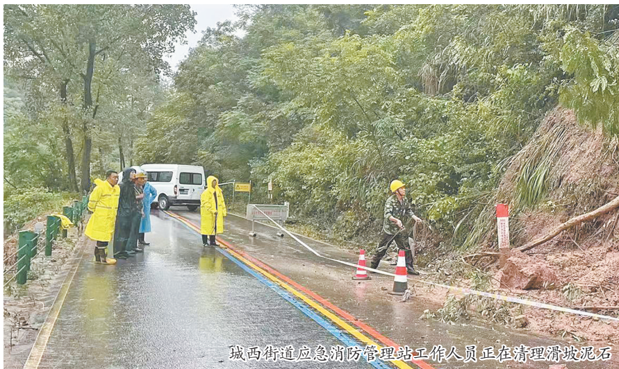
城西街道应急消防管理站工作人员正在清理滑坡泥石
