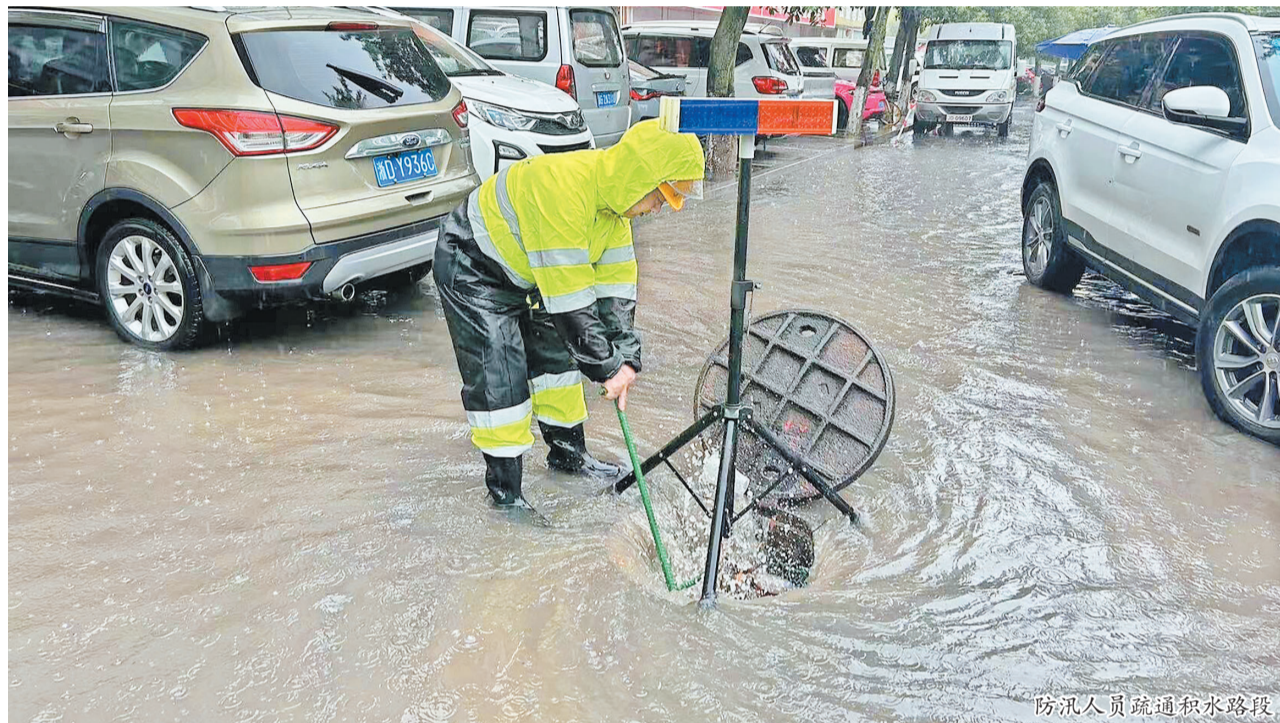
防汛人员疏通积水路段
