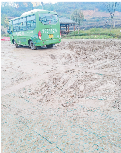
由于地面泥泞,公交站进站调头,开到站外才能让乘客上车。
